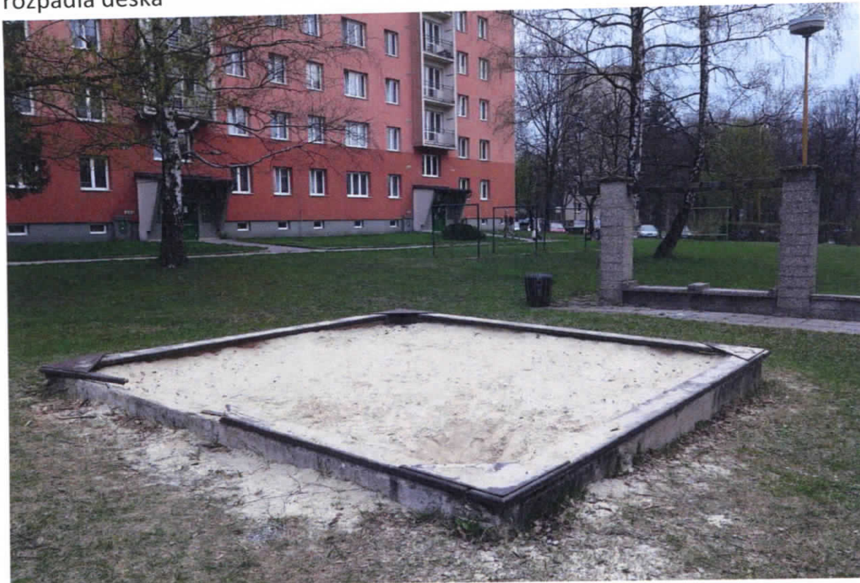
Pískoviště mezi ul. Nad Terasou a blokem domů na Dlouhé třídě 99a,b,c – rozpadlá deska
