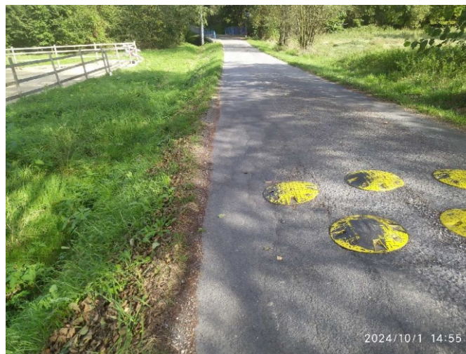
Příloha 5 - Podemletí vozovky ul. Na hranici /1
