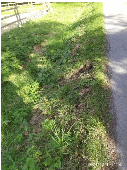
Příloha 4 - Podemletí vozovky ul. Na hranici /1
