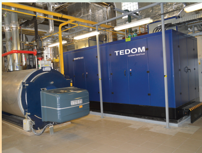
Kogenerační jednotka (vpravo) v útrobách plynové kotleny v Příboře
